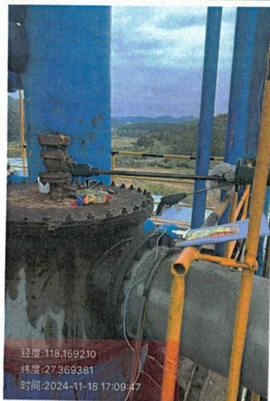
DA001 一工段工艺尾气排放筒
